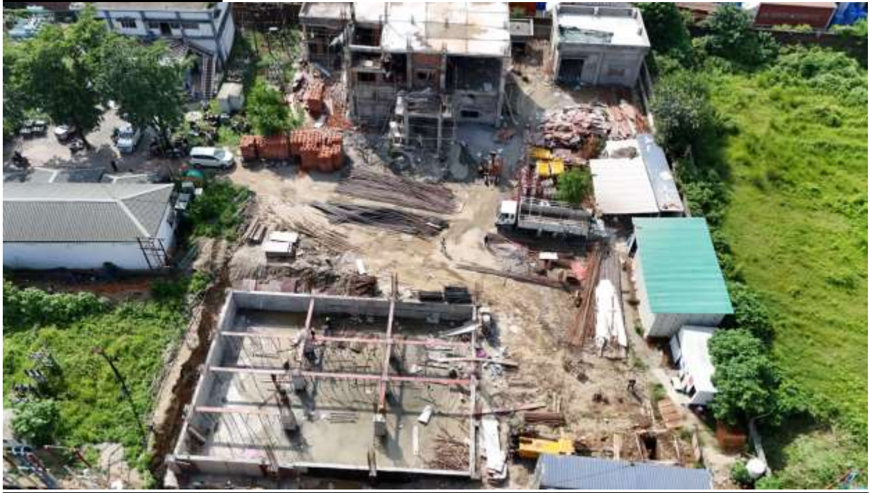
220 kv GIS S/S Selaqui
